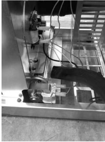
Fig. 73 - Rengøring af rumblæser
